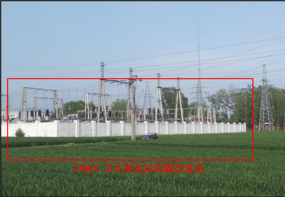
图 1-4 110kV 万古变电站间隔改造处现场照片
