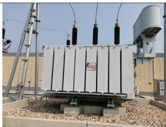
变电站现有2号主变
