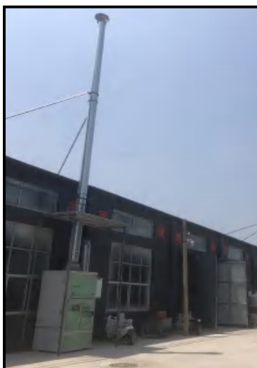
综合车间（烟剂、粉剂及乳油）及废气治理设施
